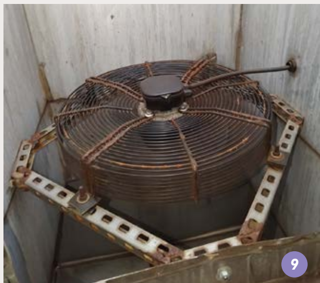
Фото 9. Вентилятор на выбросе воздуха из камеры
