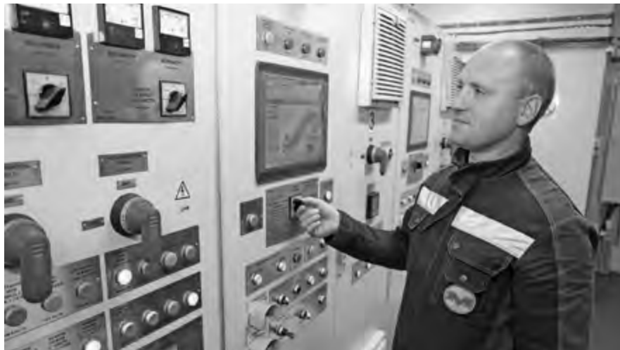
В машинном зале эскалаторов используются системы контроля, обеспечивающие высокую надежность работы оборудования
